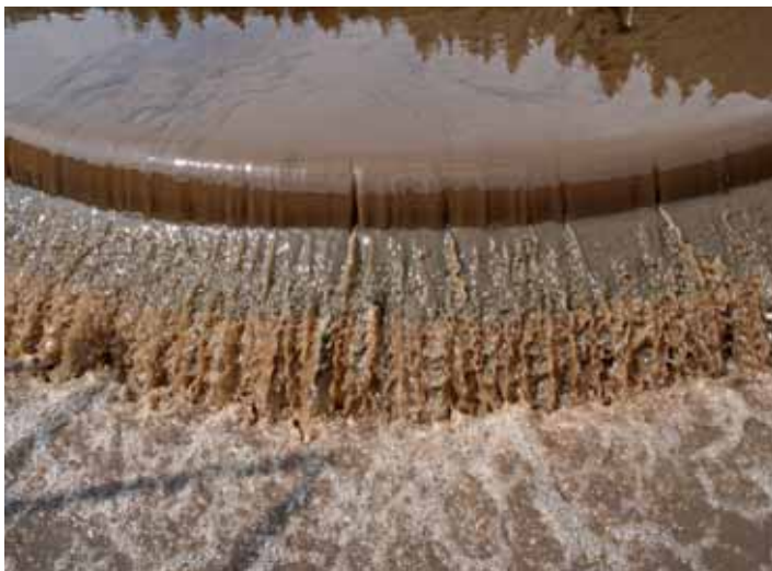
Abwassermischteller zur biologischen Abwasserreinigung
