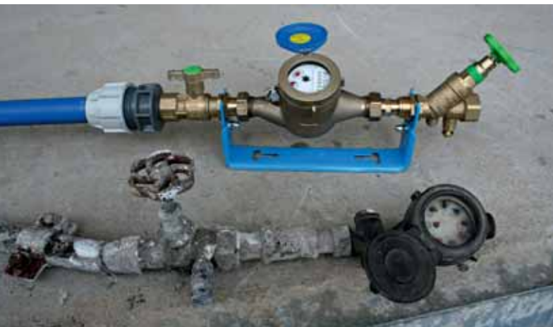
Rohre und Amaturen aus Blei sind zwingend zu ersetzen!
