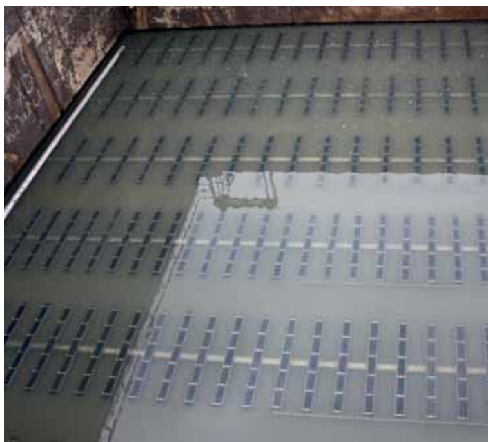
Filterplatten in der Kläranlage Plauen
