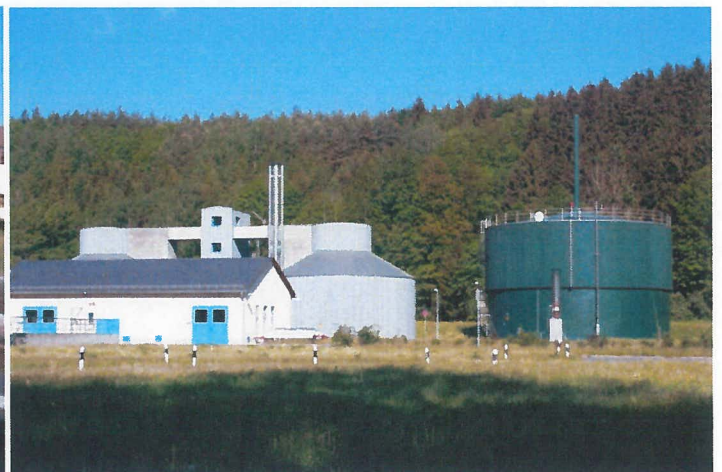
Blockheizkraftwerk mit Faulturm und Gasbehälter
